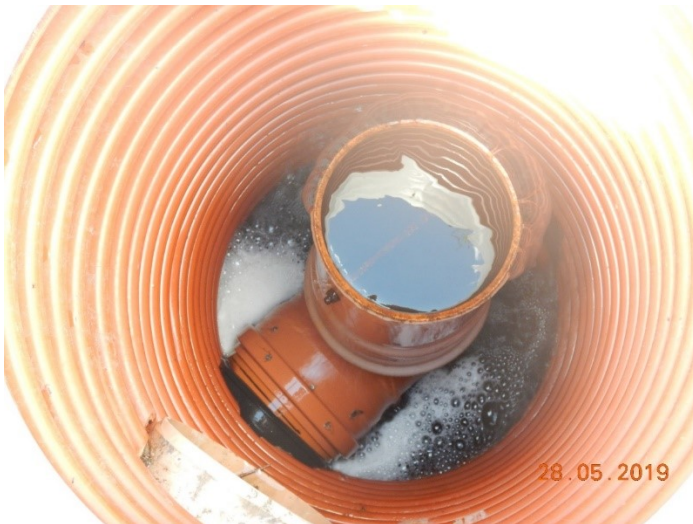
Figur 7.32 Iltningsbrønd som i Figur 7.30
