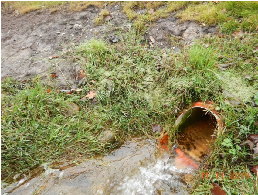
Figur 4.3 Drænrøret forsyner minivådområdet med vand.
