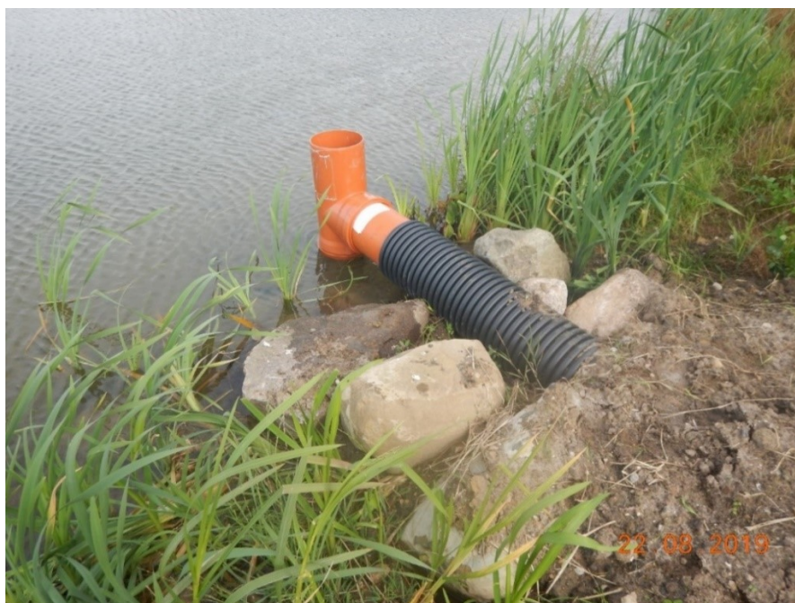
Figur 4.11 Overløbsrør. Dette sikrer, at minivådområdet ikke løber over.
