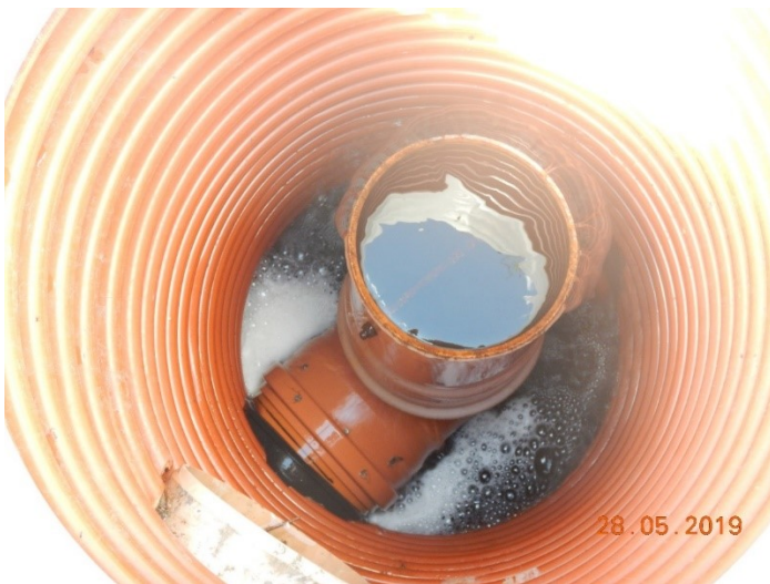
Figur 8.31 Iltningsbrønd som i Figur 7.29
