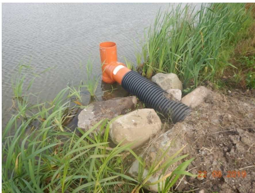
Figur 5.11 Overløbsrør. Dette sikrer, at minivådområdet ikke løber over.
