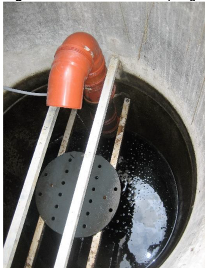
Figur 8. Fotoet viser en simpel geniltningsbrønd med en hullet plade, der medvirker ved geniltning.
