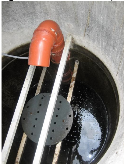
Figur 13.3 Fotoet viser en simpel geniltningsbrønd med en hullet plade, der medvirker ved geniltning.
